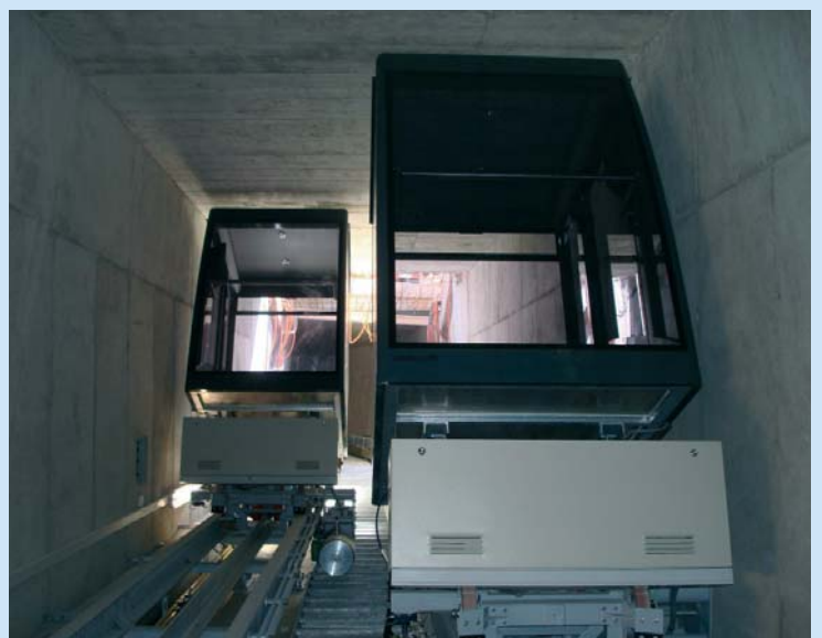
Die Chaletsiedlung in Zermatt ist mit zwei unabhängigen Crossliften unterirdisch erschlossen.
